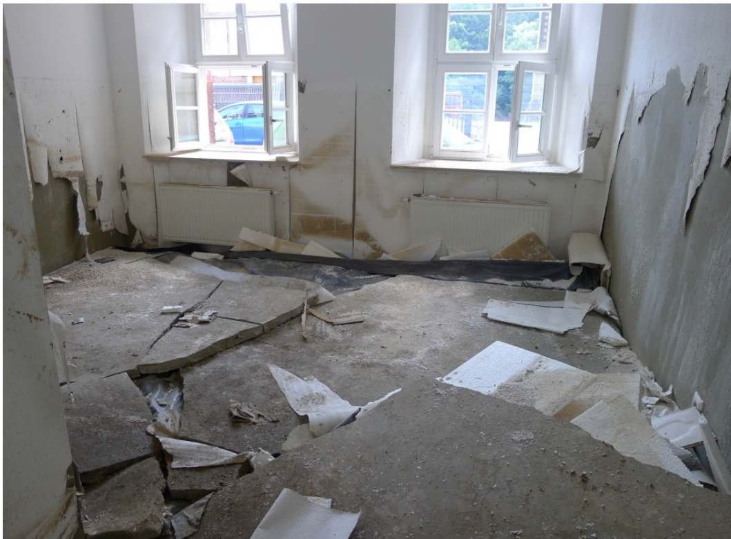
Abbildung 29: Fehlende Auftriebssicherheit einer Fußbodenkonstruktion in einem überfluteten Wohngebäude (hier: Zementestrich auf einer zweilagigen Wärmedämmung aus Polystyrol-Hartschaumplatten) führte zum Aufschwimmen und damit zu erheblichen strukturellen Schäden. © Sebastian Golz.
