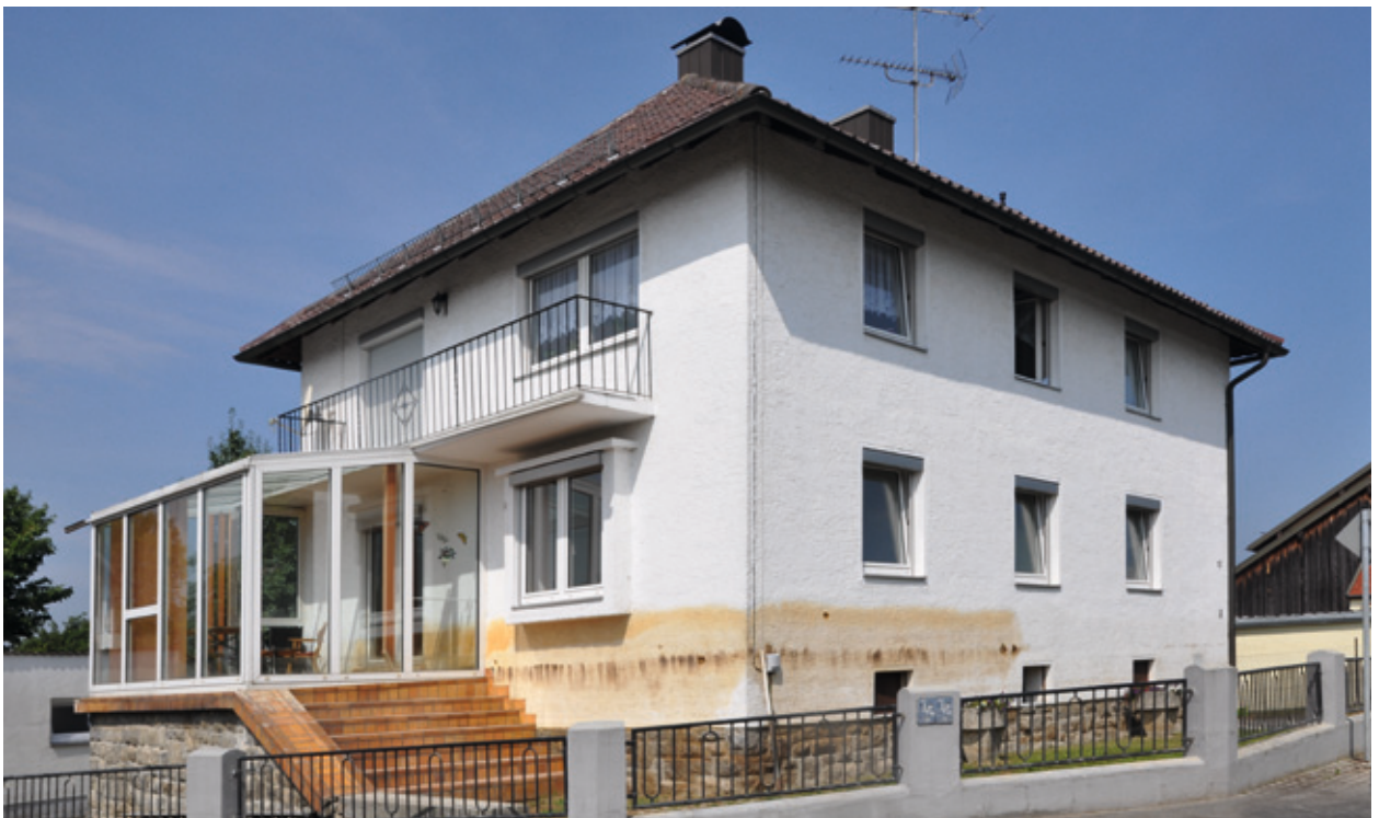
Mit Heizöl belastetes Wärmedämm-Verbundsystem eines Wohnhauses
