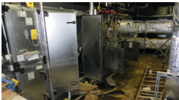
Viele Anlagenteile von Lüftungs- und Klimaanlage sind nach einer Überflutung auszutauschen
