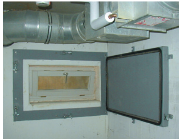
Druckdichte Fenster verhindern das Eindringen von Hochwasser in Lagerräume.
