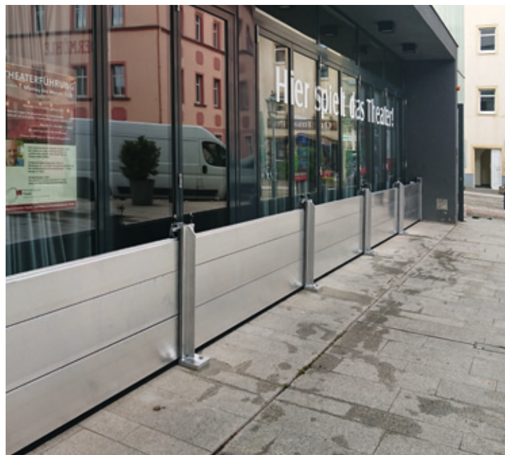
Objektschutz mit teilmobilen Schutzelementen
